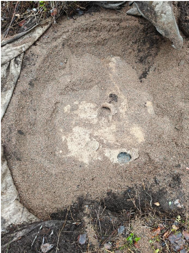
Kuva 6. Koekuopan KK6 alueella oli kasvukerroksen alapuolella suodatinkangas, jonka alla hiekkaa noin 20 cm ja, jonka alla oli vielä toinen suodatinkangas ja toinen kalvorakenne (HDPE-kalvo?).
