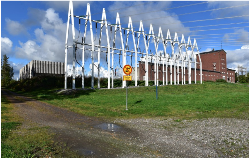
Kuva: Uuden sähköaseman kanssa samaan aikaan rakennettiin veistokselliset voimajohtorakenteet.
