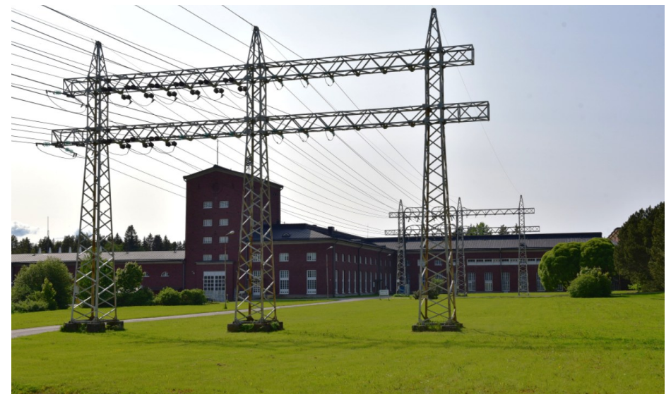
Kuva: Kytkinasema ja voimalinja.
