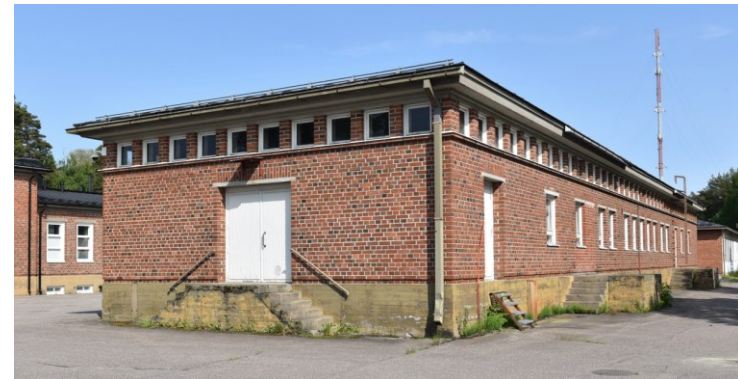
Kuva: Länsipääty ja eteläjulkisivu. Jälkimmäiseen on lisätty ikkunoita ja korvattu yksi ovi ikkunalla.
