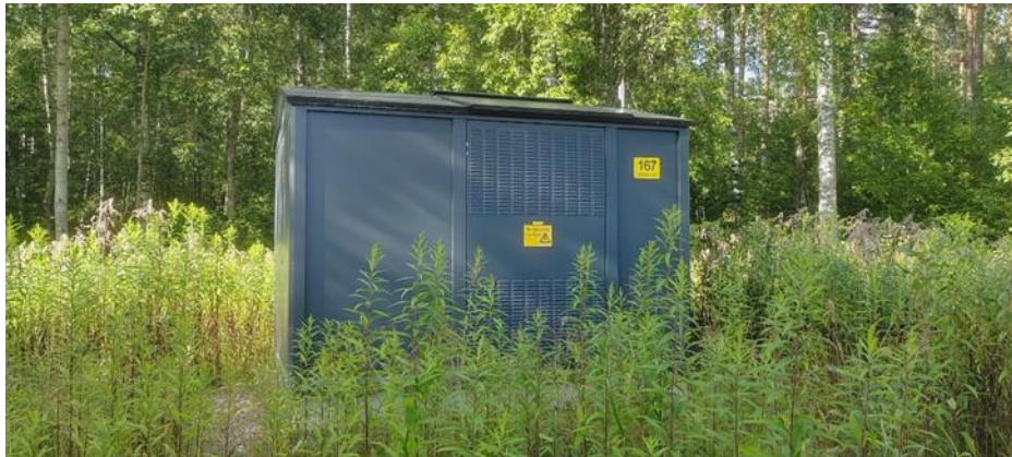
Kuva 13. Nykyaikainen puistomuuntamo, jossa pohjaveden ja maaperän suojaus on kunnossa.
