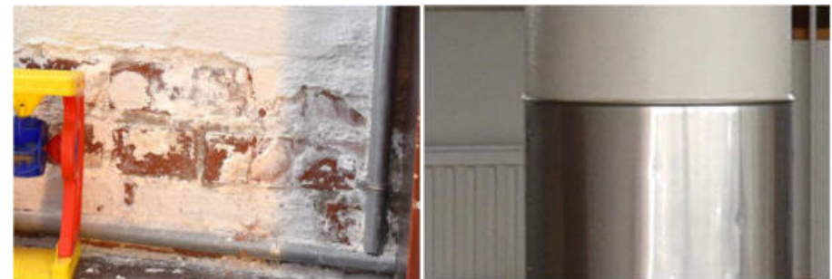
Kuva: Ohutrappaus ja maali. Kosteusvaurioitunut tiiliseinä.
