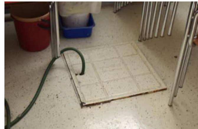
Kuva: Kellarikerroksessa olevan kokoojakaivo.
