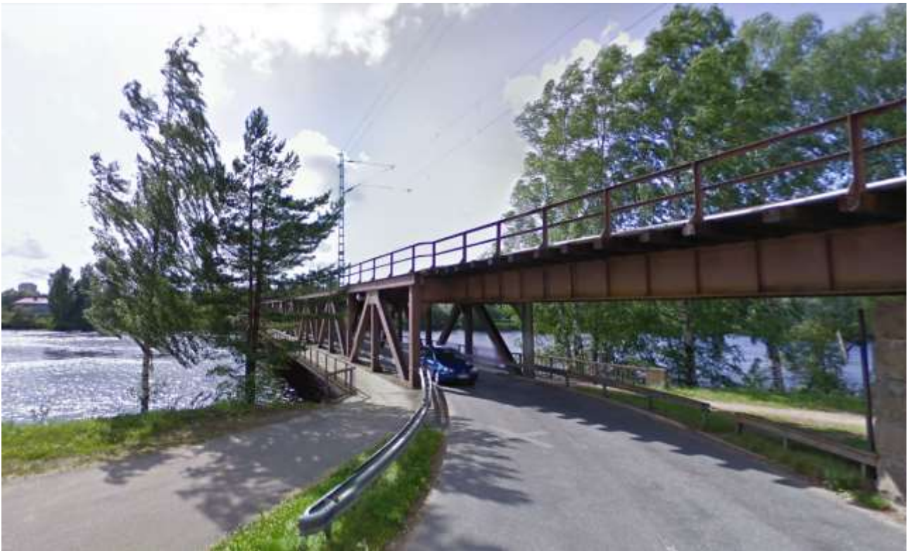
Kuva 8.5. Imatra-Luumäki-ratahankkeen myötä Vuoksen ylittävä Mansikkakosken vanha ratasilta on kunnostettu ja poistunut rautatieliikenteen käytöstä. Korvaava uusi kahden raiteen ratasilta on rakennettu nykyisen sillan pohjoispuolelle. (Väylävirasto, Luumäki–Imatra-ratahanke.) Kuva: GoogleMaps.
